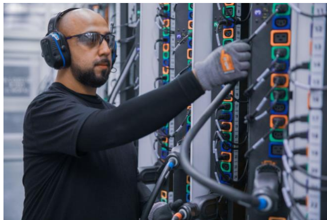
Figure 5 : Un datacenter technician qui travaille sur les PSU
